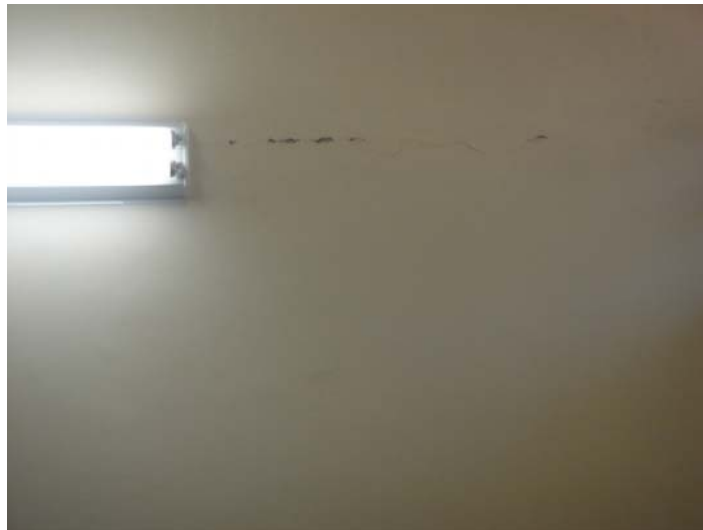
Foto 11 – URS Centro – Teto com rachaduras
