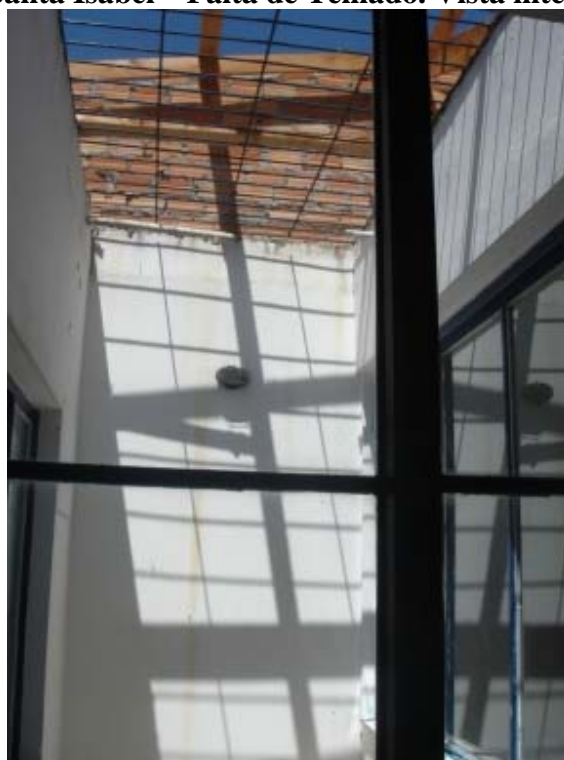
Foto 6 – UBS Santa Isabel – Falta de Telhado. Vista interior da Unidade
