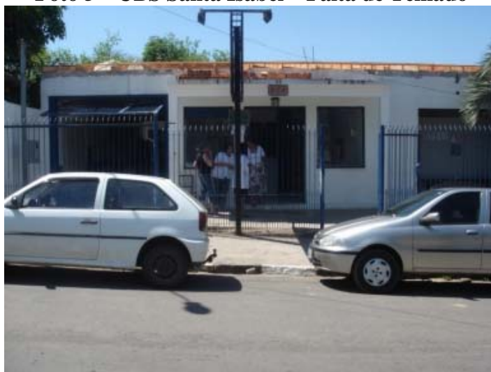
Foto 5 – UBS Santa Isabel – Falta de Telhado
